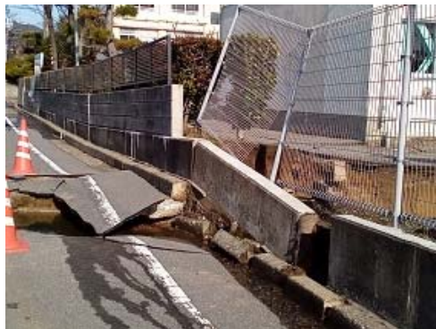
新潟県新潟市 路面の隆起 （1月2日）
