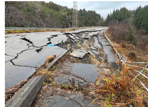
石川県七尾市 道路被害 （1月9日）
