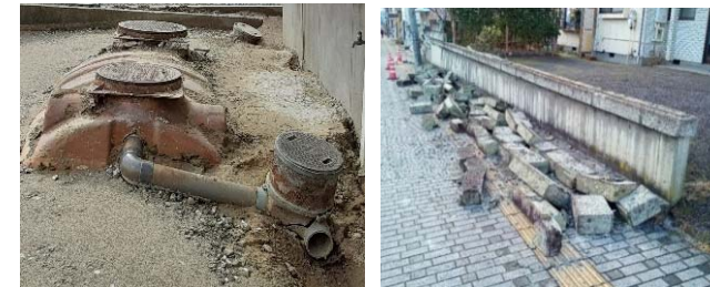
■ 液状化等の被害状況調査（新潟県）
