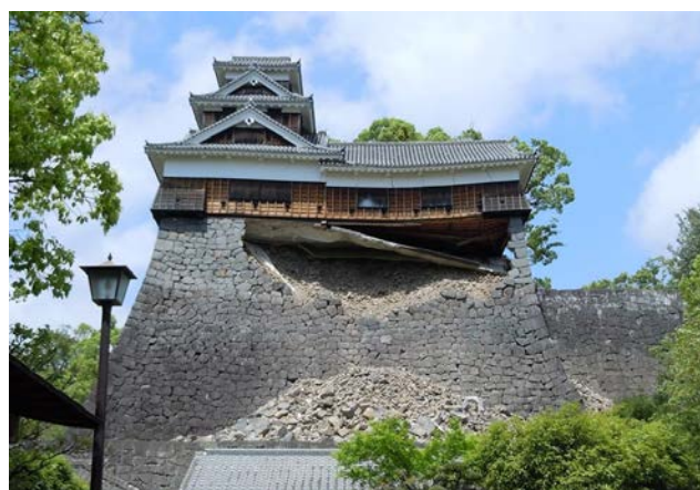
熊本城石垣の崩落
